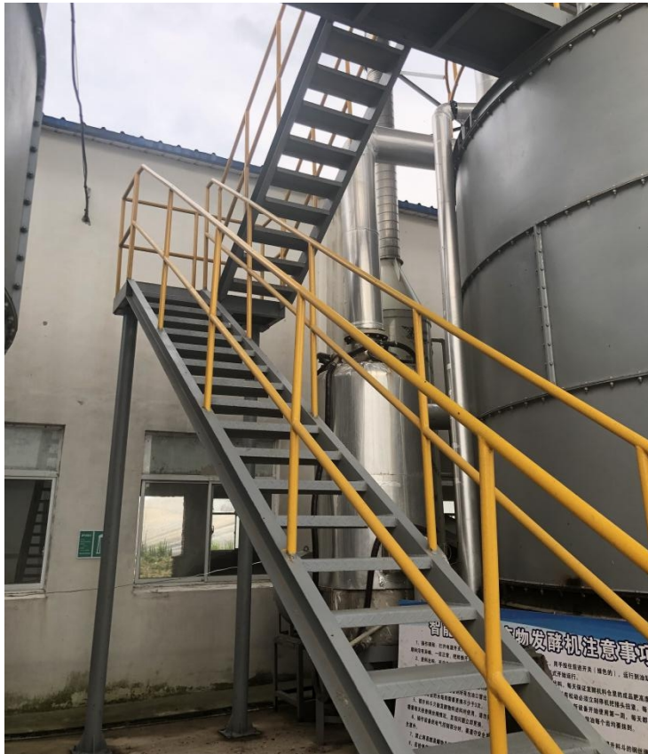
高速堆肥发酵机及排气筒（4#）
