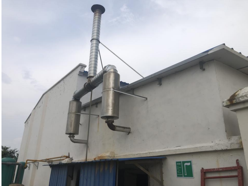
沼气发电机及排气筒（1#）
