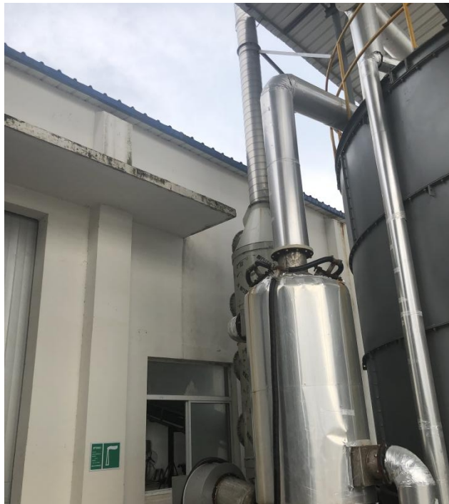
高速堆肥发酵机及排气筒（3#）
