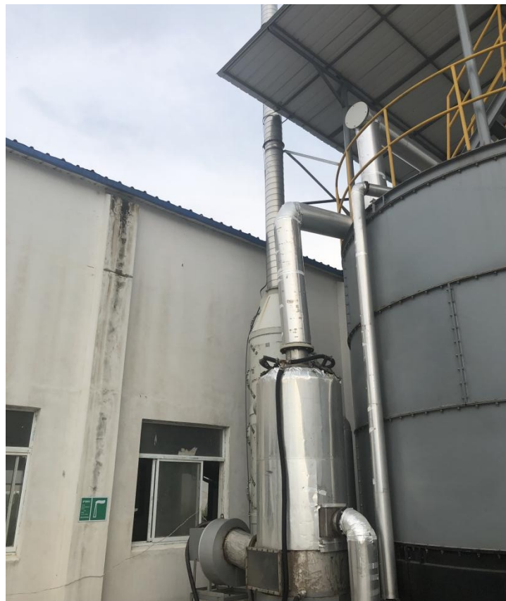
高速堆肥发酵机及排气筒（5#）
