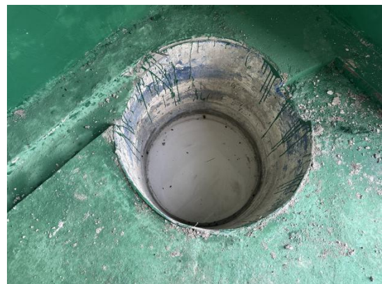
危废仓库收集池
