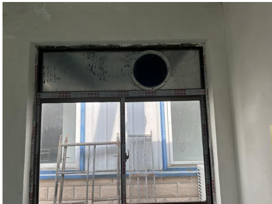
危废库废气收集管道
