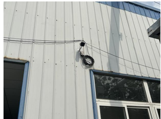
危废仓库外部摄像
