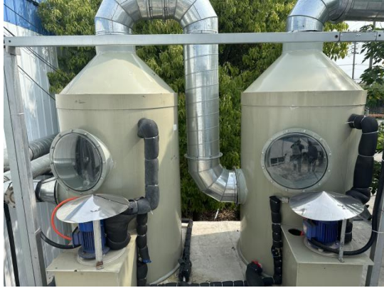
二级氨气吸收塔
