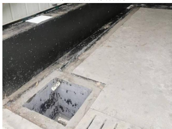
危废仓库导流沟及收集池
