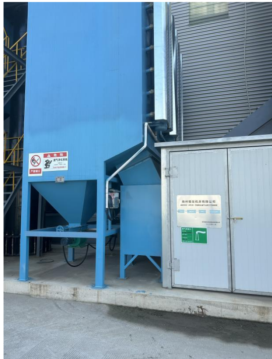
打磨房滤筒式除尘器
