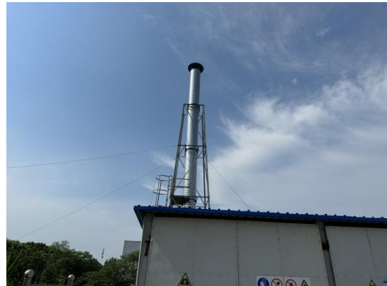
危废库排气筒
