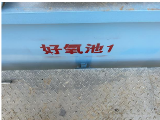
生化池（好氧池）
