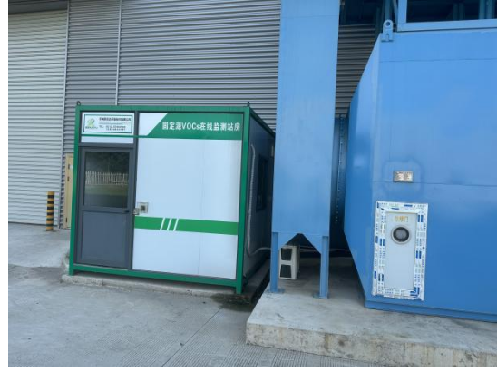
喷漆房在线监测室
