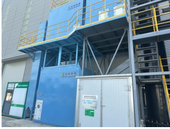
喷漆房废气处理装置
